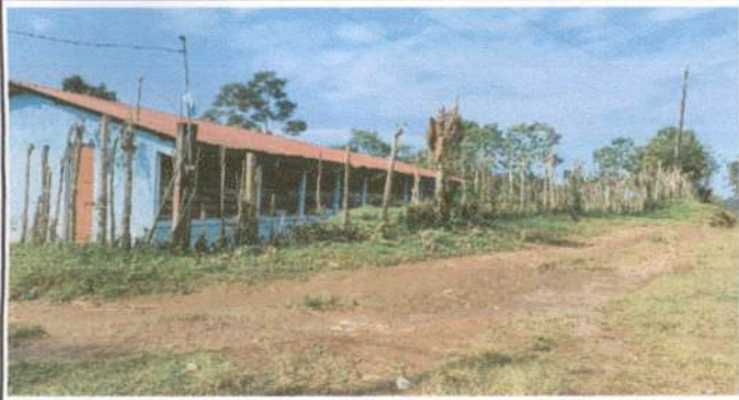
MÓDULO 1 AULAS: CUBIERTA DE LÁMINA: Sustitución de lámina, por lamina troquelada aluzinc calibre 26, Sustitución de capote para lámina troquelada, Sustitución elementos de fijación.
